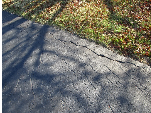
Pavement edge cracks
