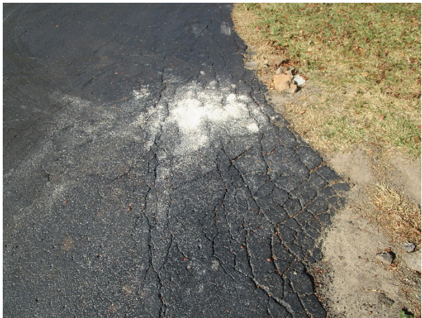
Pavement edge cracks
